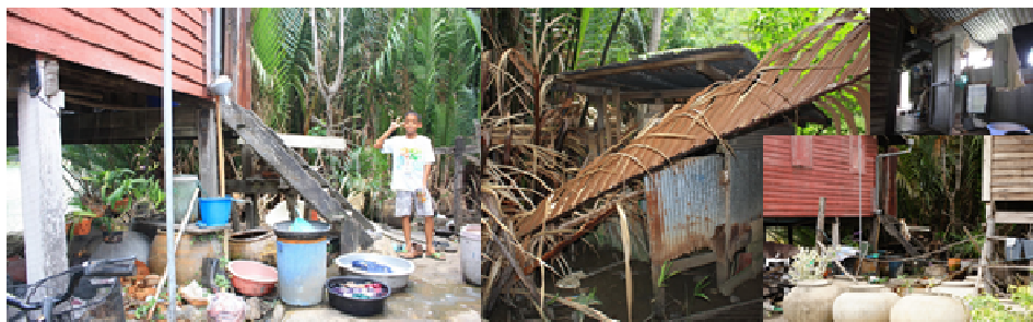
ภาพที่ 4.21 แสดงรูปลักษณะที่อยู่อาศัยของนางวัชรีย์ โยชนันที่ถูกน้ำกัดเซาะ
