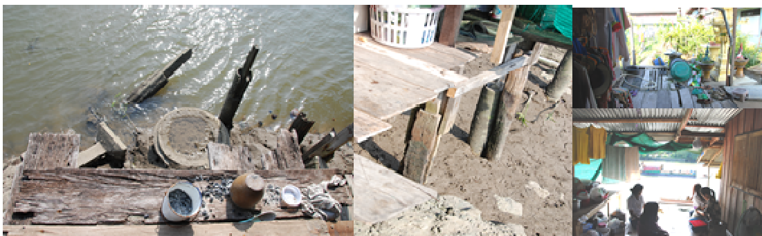
ภาพที่ 4.25 แสดงรูปลักษณะที่อยู่อาศัยของนางนิตยา คงศรี ที่ถูกน้ำกัดเซาะ
