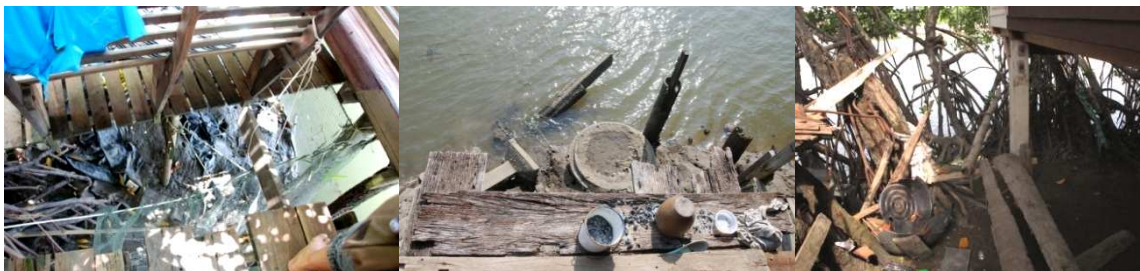
ภาพที่ 5.6 แสดงที่อยู่อาศัยที่ได้รับผลกระทบจากลักษณะการกัดเซาะทั้งพื้นที่ดิน และที่อยู่อาศัย
