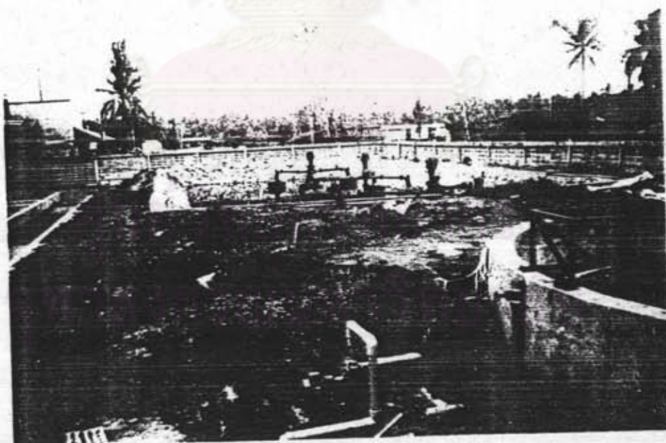
ภาพที่ 12 แสดงลักษณะของบ่อบำบัดน้ำเสียที่ใช้สำหรับสูบน้ำก่อนจากบ่อตกตะกอนลงสู่อ่างน้ำเสีย
