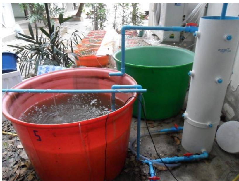
ภาพที่ 3.4 ชุดทดสอบประสิทธิภาพหน่วยแยกตะกอนที่มีการติดตั้งตัวแยกตะกอนภายในหน่วยแยกตะกอน
