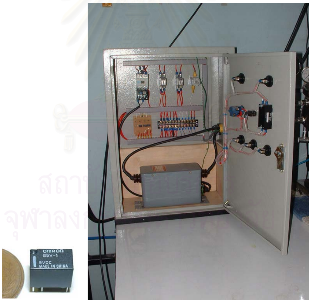
รูปที่ 3.18 ตู้ควบคุมประกอบด้วยรีเลย์รุ่น G5V-1 แรงดันคอยล์ 5 VDC 30 mA แรงดันหน้าสัมผัส 0.5 A 125 VAC หม้อแปลงไฟฟ้า และสวิตช์ไฟฟ้าที่จ่ายไฟเข้าสู่ชุดทดลอง
