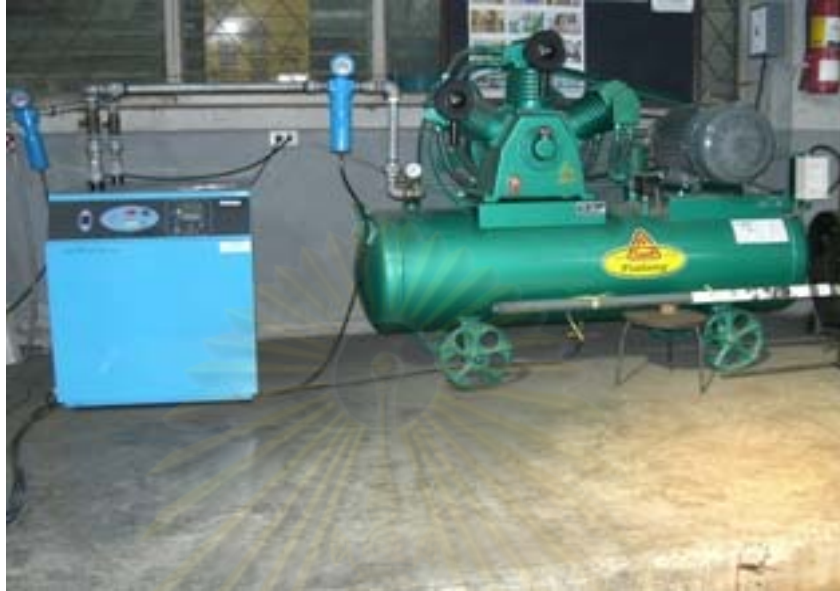
รูปที่ 3.15 เครื่องอัดอากาศ พร้อมอุปกรณ์ทำความเย็นอากาศและระบบกำจัดน้ำในอากาศ
