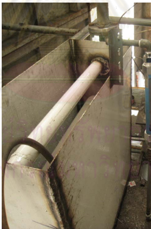
รูปที่ 3.22 ส่วนอุ่นน้ำ (Water Pre-Heater)
