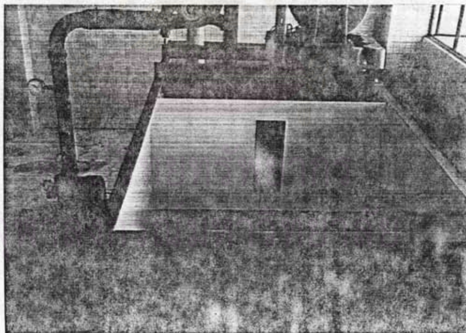
รูปที่ 2.4 มาตรวัด rectangular weir
