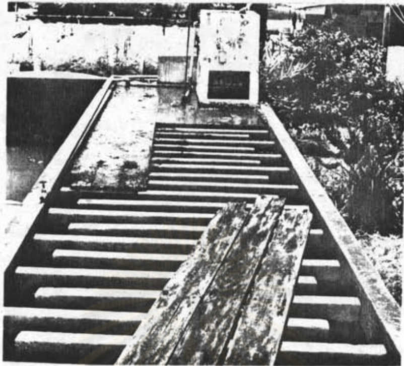
ภาพที่ 5.12 สภาพทั่วไปของถังรวมตะกอน การประปาห้วยกะพง
