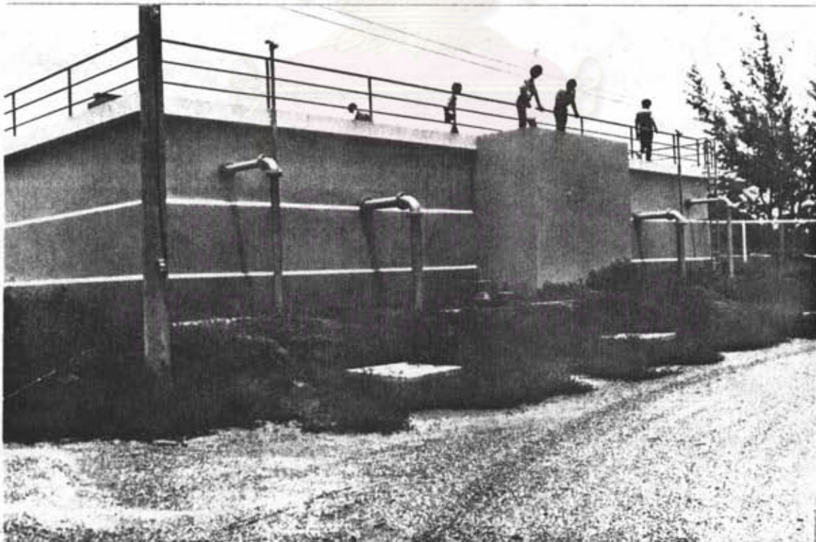
ภาพที่ 5.42 สภาพทั่วไปของถังทรายกรองซึ่งการประปาว่าัดญาณสังวรารามตั้งภาพจะเห็น ส่วนควบคุมระดับน้ำเหนือชั้นทรายบริเวณกลางถังกรอง
