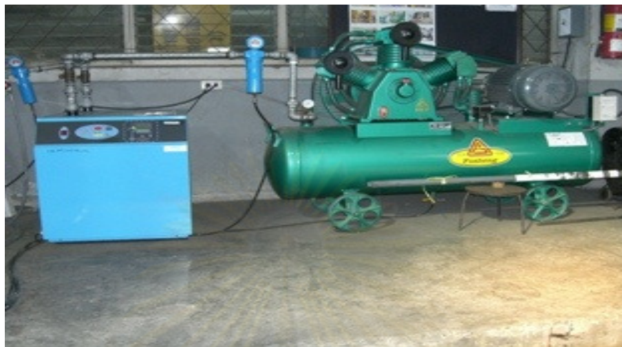
รูปที่ 3.9 เครื่องอัดอากาศ
