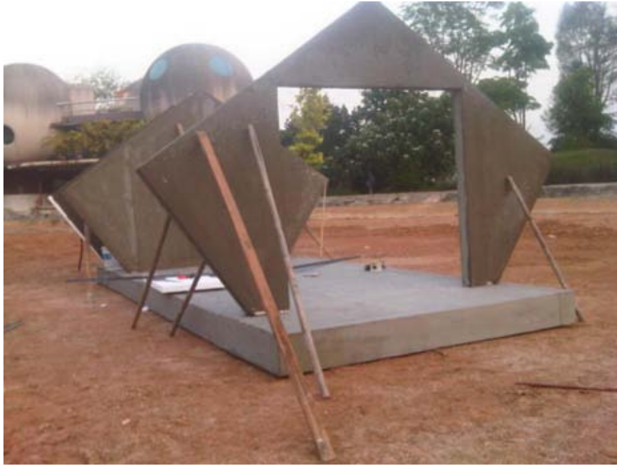
ภาพที่ 4-46 แสดงขั้นตอนการติดตั้งผนัง 5 เหลี่ยมด้านหน้า และด้านหลัง ขอบยึดติดด้วย base coat ทำค้ำยัน ใช้เวลา 2 วันเพื่อให้แห้งสนิทเพิ่มความแข็งแรง
