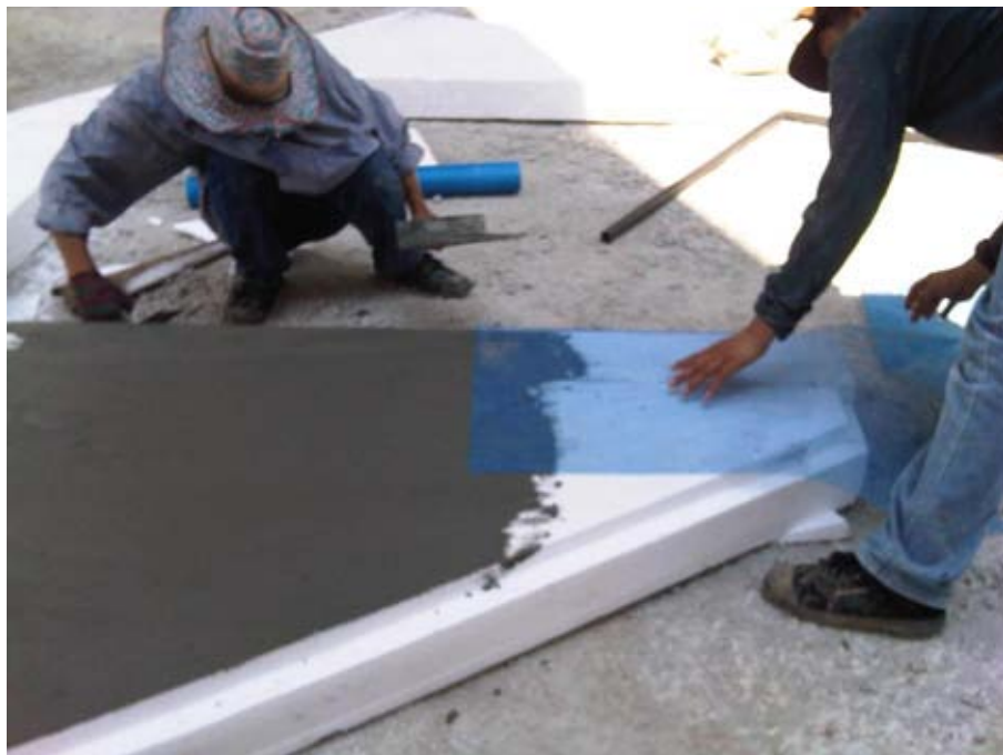
ภาพที่ 4-45 แสดงขั้นตอนการแสดงการติดตะแกรงไฟเบอร์กลาส เพื่อฉาบผิว
