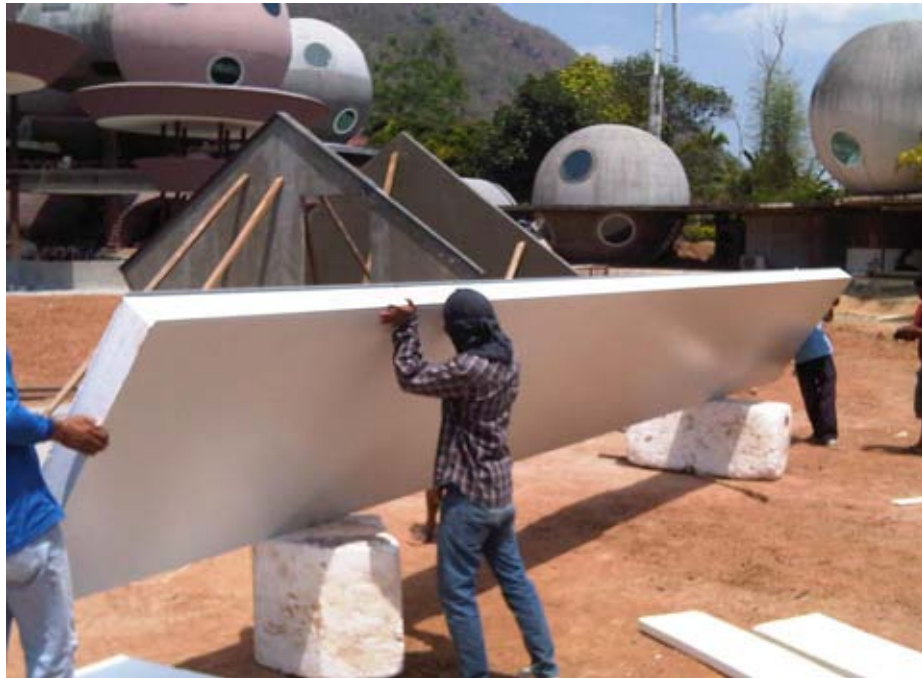
ภาพที่ 4-48 แสดงขั้นตอนการติดตั้งชิ้นส่วนผนัง โฟม panel ด้านข้าง
