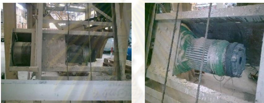
รูปที่ 5.28 motor กว้านของ Skip Hoist
