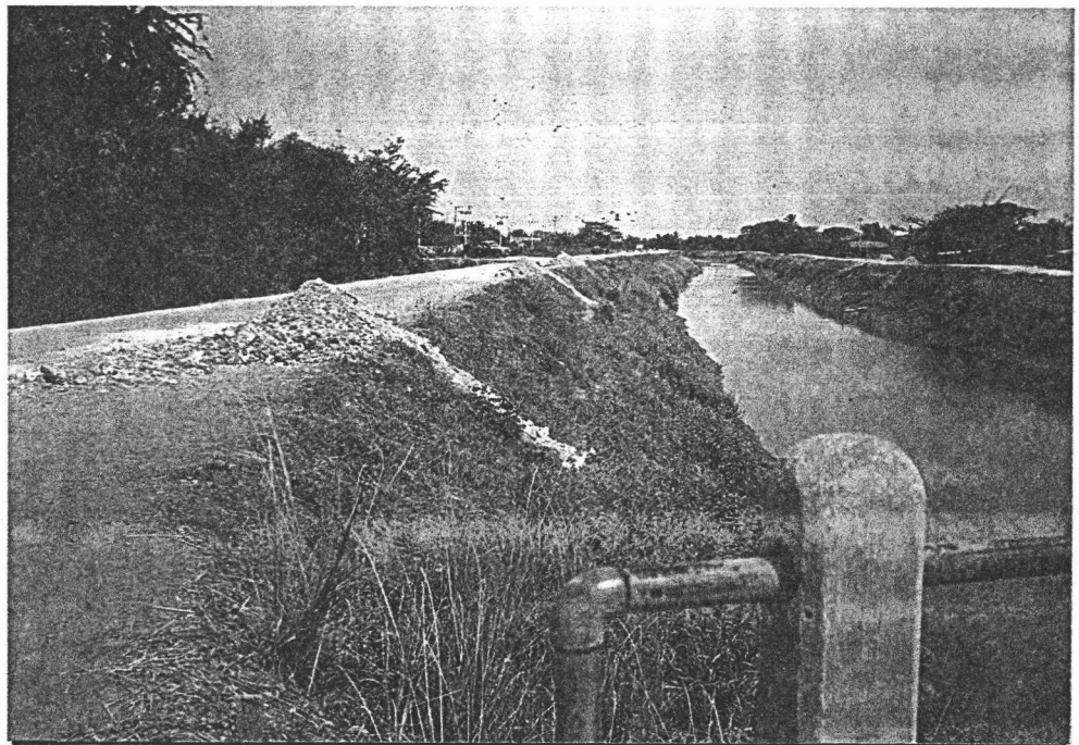
สภาพถนนแนวคันคลองชนประตวนโดยทั่วไป
