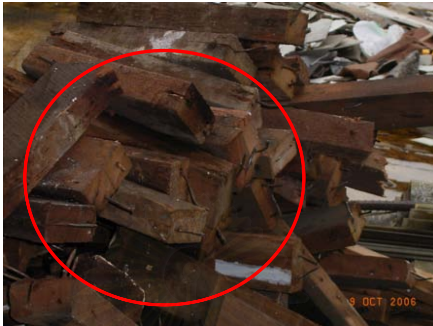
รูปที่ 4.23 กองไม้ที่เกิดจากการรื้อถอนสิ่งก่อสร้างโดยที่ยังมีตะปูติดอยู่
