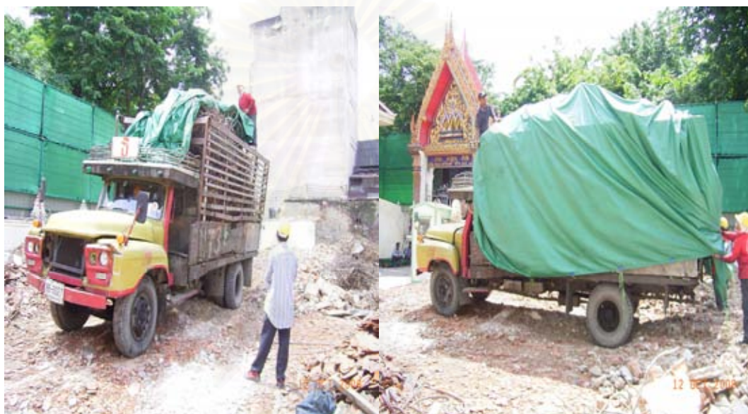
รูปที่ 4.15 การใช้แผ่นวัสดุคลุมรถบรรทุกก่อนขนย้ายเหล็กเสริมคอนกรีตที่เกิดจากการรื้อถอน
