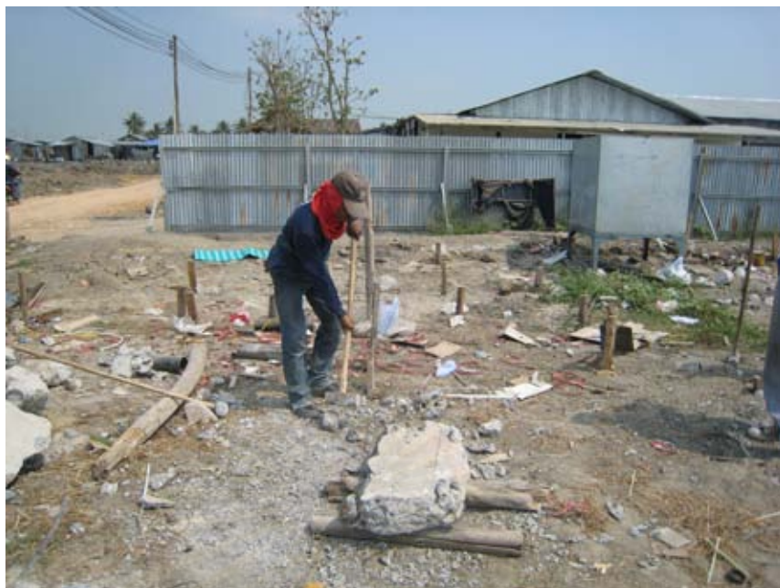
รูปที่ 5.2 การทุบย่อยคานคอนกรีตโดยใช้คนงาน 1 คน
