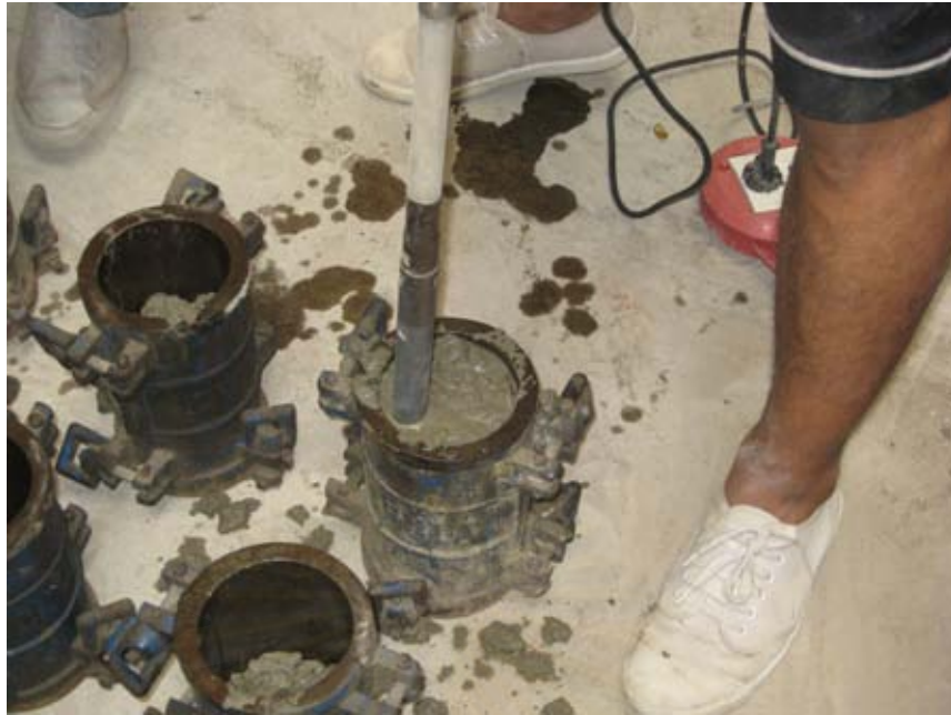
รูปที่ 5.29 การใช้เครื่องจี้คอนกรีต (Vibrator) เพื่อให้ก้อนตัวอย่างแน่นปราศจากช่องว่าง
