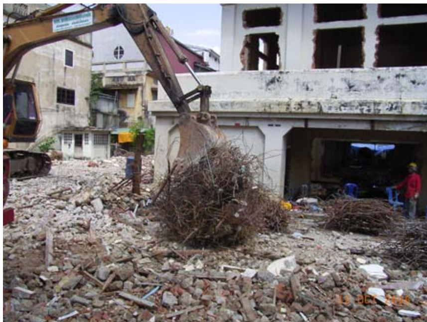
รูปที่ 4.13 การบีบอัดกองเหล็กเสริมคอนกรีตเพื่อถ่ายโอนย้าย
