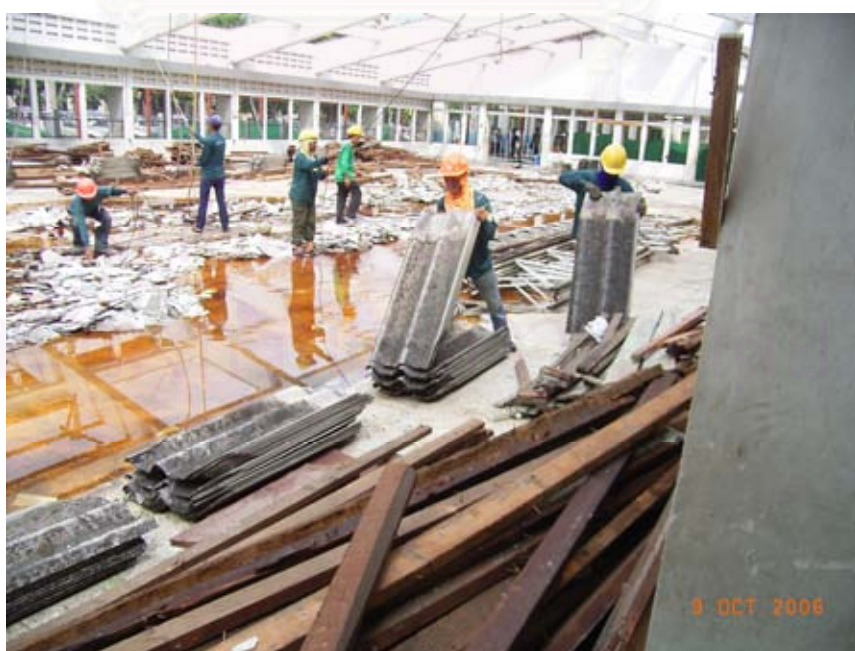
รูปที่ 4.42 การกองวัสดุผนังหลังคาที่เกิดจากการรื้อถอนสิ่งก่อสร้างเพื่อรอการขนย้าย
