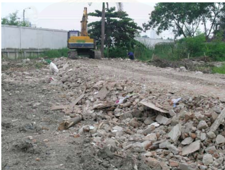
รูปที่ 4.9 ถนนชั่วคราวในสถานที่ก่อสร้างโดยถมจากเศษคอนกรีตที่เกิดจากการรื้อถอนสิ่งก่อสร้าง
