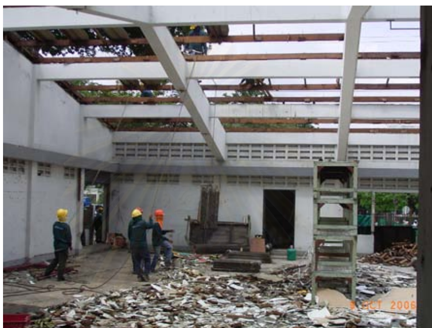
รูปที่ 4.41 การขนย้ายวัสดุผนังหลังคาที่เกิดจากการรื้อถอนสิ่งก่อสร้างลงมากองไว้ด้านล่าง
