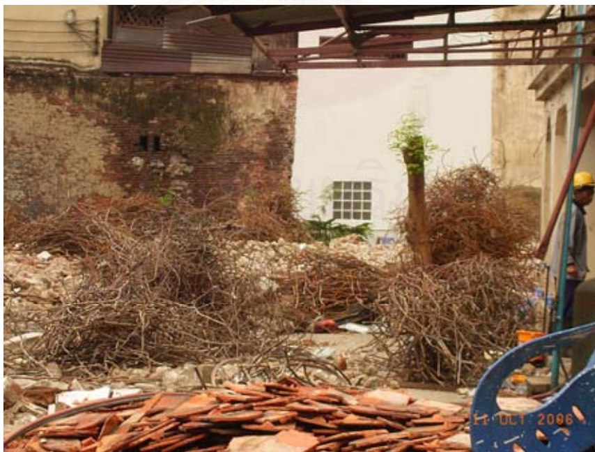
รูปที่ 4.12 การกองเหล็กเสริมคอนกรีตที่เกิดจากการรื้อถอนสิ่งก่อสร้างเพื่อรอการขนย้าย
