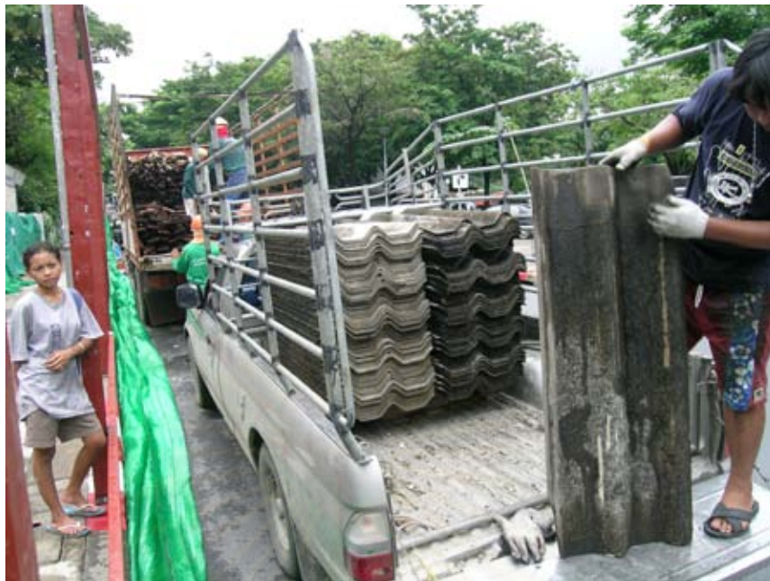
รูปที่ 4.43 การขนย้ายวัสดุมูลงหลังคาที่เกิดจากการรื้อถอนสิ่งก่อสร้าง
