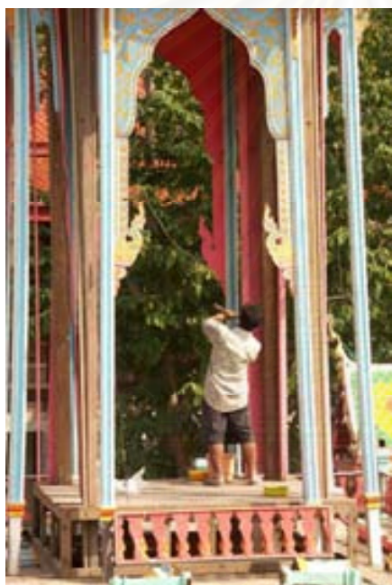
ภาพที่ 4.2.3.2.2 โครงสร้างส่วนเรือนธาตุ เมรุชั่วคราววัดพระทอง
