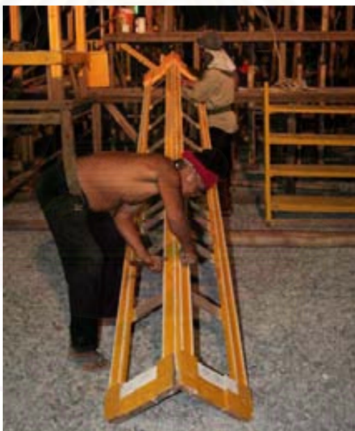
ภาพที่ 4.1.3.2.1 ช่างกำลังประกอบเสาแผงสองด้านเข้าด้วยกัน ก่อนนำขึ้นไปติดตั้ง (เมรุวัดเกาะ)
