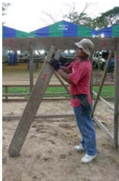
ภาพที่ 4.2.2.2.3 เสาค้ำคานยึดแผงฐานด้านบน
