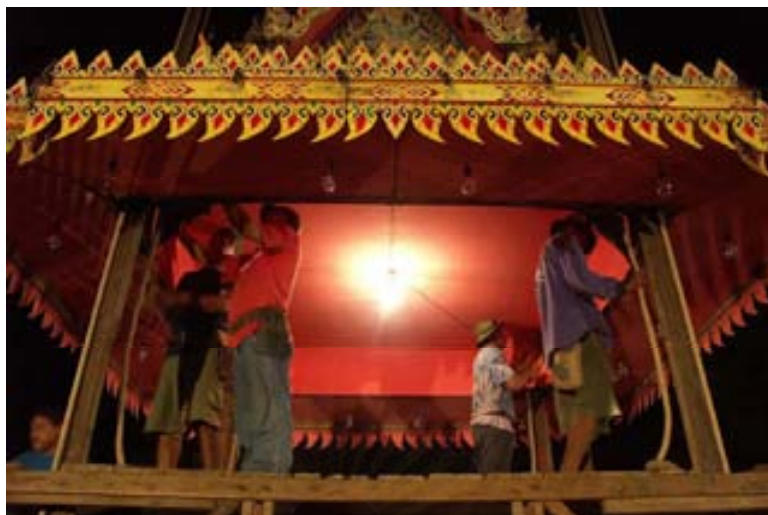
ภาพที่ 4.2.2.3.21 ช่างกำลังทำการติดตั้งส่วนเพดานของเมรุประธาณ
