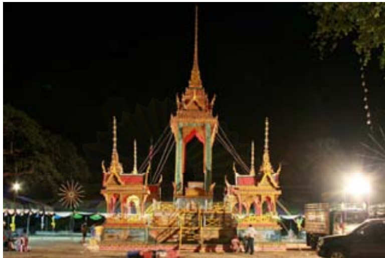
ภาพที่ 4.2.4.3.10 ช่างทำการติดตั้งแผงล่องถนน เสาระเบียง พนักกระเบียง และบันได
