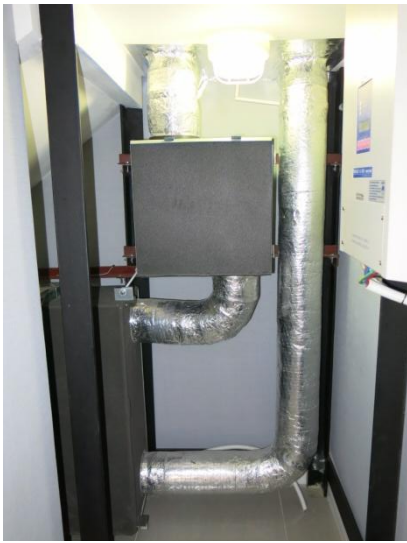
3.48 เครื่อง Air Factory
