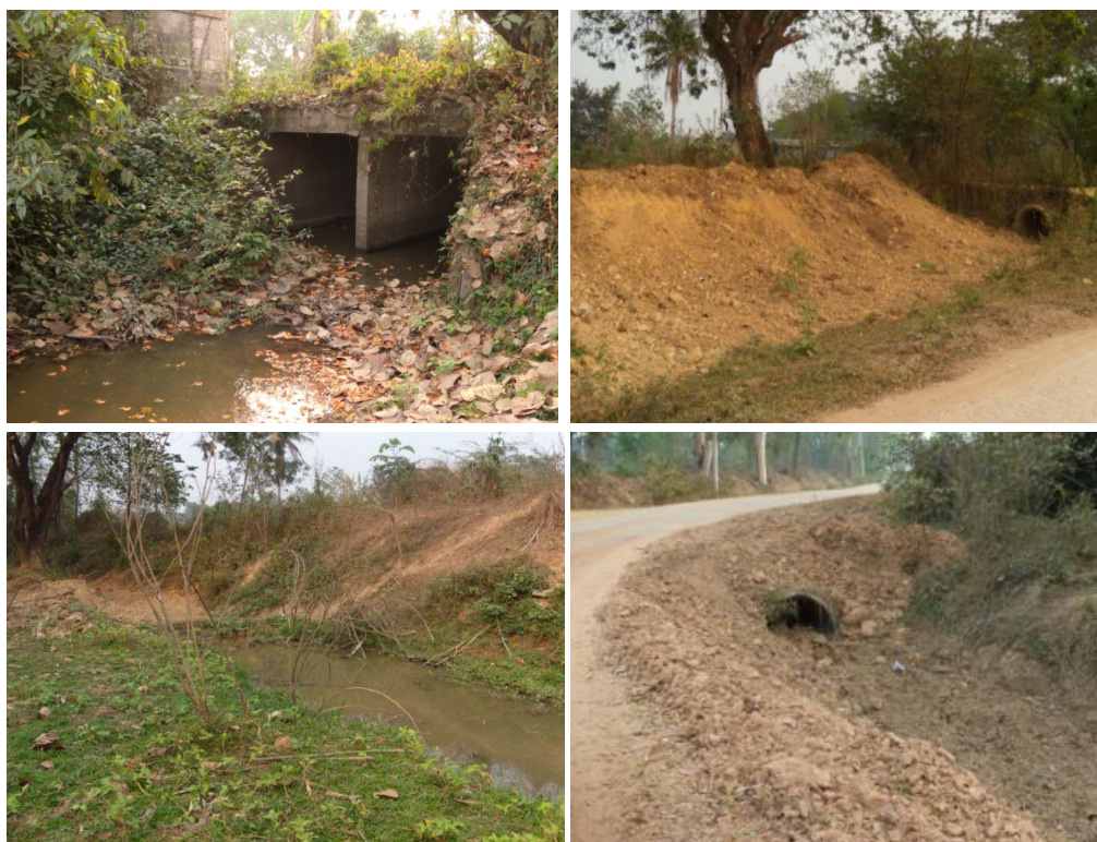
ภาพที่ 5.15 เศษวัสดุอุดตันทางระบายน้ำในเขตเมืองน่าน
