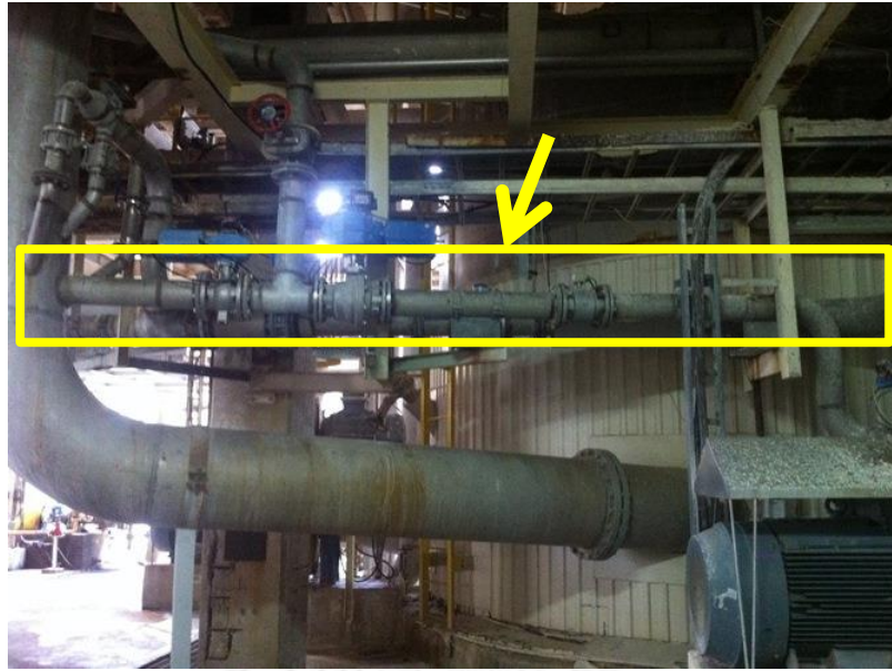
รูปที่ 5. 2ท่อส่งเยื่อ EOP หลังการปรับปรุงเพื่อส่งเยื่อไปยังถัง LC โดยตรง
