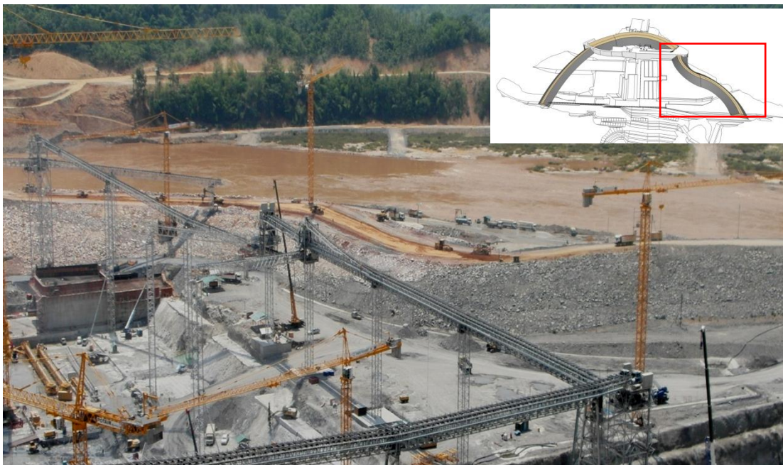
ภาพที่ 4.16 แสดงการก่อสร้างบริเวณท้ายเขื่อนไชยะบุรี เพื่อผลิตไฟฟ้าพลังน้ำ
