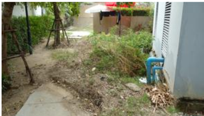
ภาพที่ 4.34 ทางเดินที่เกิดความเสียหายและขาดออกจากกัน ส่งผลให้ผู้ใช้งานเกิดความสับสนในการใช้พื้นที่ (ถ่ายเมื่อวันที่ 19 มกราคม 2557)
