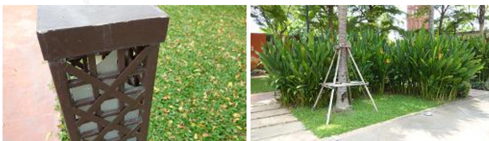
ภาพที่ 4.54 และ ภาพที่ 4.55 สภาพการแตกหักของโคมไฟสนาม และ ลักษณะไม้พุ่มสูงที่ก่อให้เกิดการบดบังทางสายตา ตามลำดับ (ถ่ายเมื่อวันที่ 18 มกราคม 2557)
