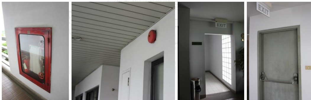
ภาพที่ 28 แสดงชุดอุปกรณ์ดับเพลิง สัญญาณฉุกเฉิน และทางออกฉุกเฉิน
