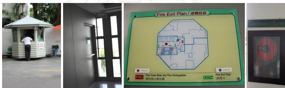
ภาพที่ 67 แสดงระบบรักษาความปลอดภัย ทางหนีไฟ และชุดอุปกรณ์ดับเพลิง
