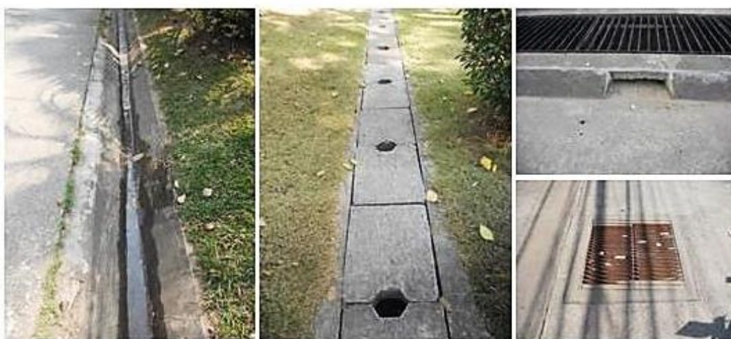
ภาพที่ 5.5 ท่อระบายน้ำคอนกรีตรูปแบบต่างๆ ของสำนักงานภายในศูนย์ราชการจังหวัดขอนแก่น
