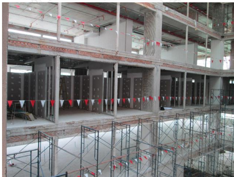
ภาพที่ 46 แสดงราวกันตกเพื่อป้องกันการตกของคน
