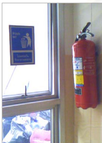
ถังดับเพลิง
