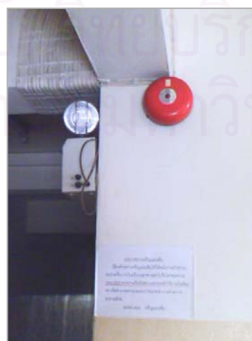
ไฟฉุกเฉินและสัญญาณเตือนเพลิง
