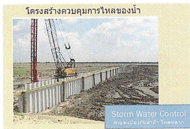
รูปที่ 5.36 กำแพงป้องกันน้ำ (Stormwater Control)
