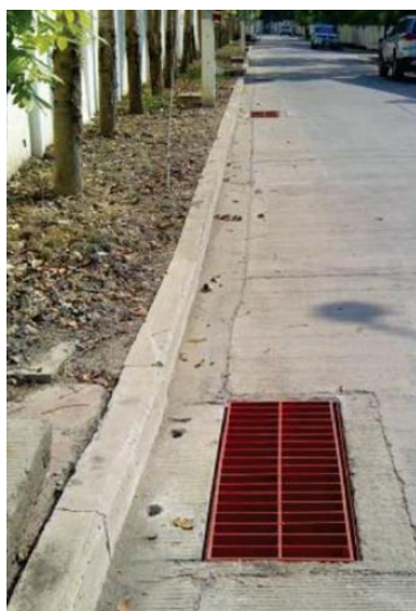
รูปที่ 5.53 แสดงรูปฝาตะแกรงเหล็กบ่อพักติดรั้วโครงการที่ใช้เป็นแนวรางระบายน้ำ (Gutter)
