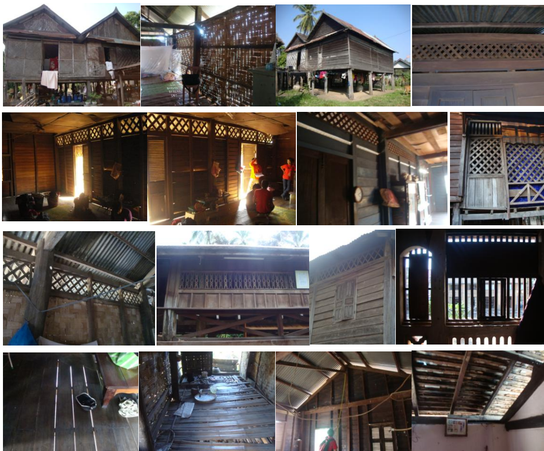
ภาพที่ 5.28 ภาพแสดงลักษณะของช่องเปิดที่อยู่บริเวณใต้หลังคา ผนัง และพื้นเรือน
