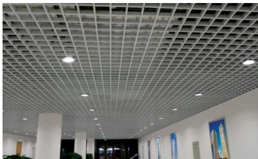
รูปที่ 8 ฝ้าอลูมิเนียมแบบตะแกรง
