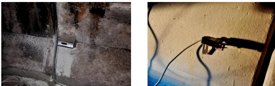
รูปที่ 3.9 ระบบการตรวจจับเพลิงติดตั้งที่บริเวณกึ่งกลางของขอบทางทั้งสองข้าง
