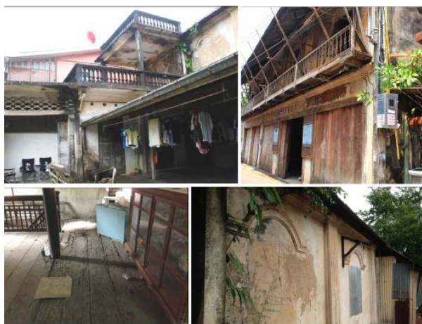
ภาพที่ 5.38 ภาพก่อนการบูรณะบ้านพักประวัติศาสตร์หลวงราชไมตรี
