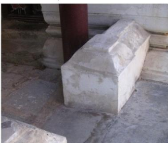
พนักระเบียง วิหาร(อุโบสถเดิม) วัดบางพลับ
