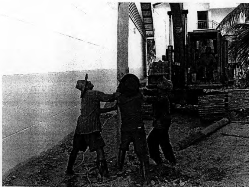
รูปที่ 3.5 ลักษณะของผู้ช่วยคนขับรถขุดดินประคองเสาเข็มให้อยู่ในแนวตั้ง
