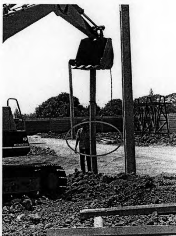
รูปที่ 3.9 การหักของเสาเข็มเนื่องจากแนวการกดไม่ได้ระนาบตั้ง
