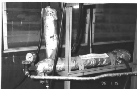
รูปที่ 3.4 ถังพักคาร์บอนไดออกไซด์เหลว
