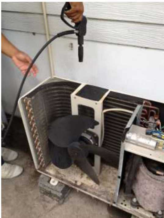
รูป 44 ตรวจสอบภาพ ทำความสะอาดแผงคอยล์ร้อน ใบบัดลมคอยล์ร้อน
