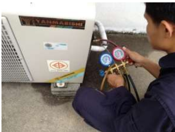
รูป 36 ตรวจสอบความดัน เต็มสารทำความเย็น
