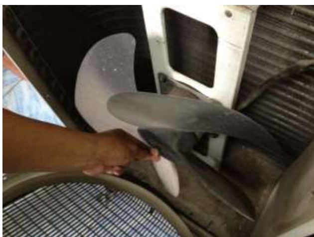
รูป 48 ทำความสะอาดใบพัดลมคอยล์ร้อน แกนมอเตอร์ ตรวจสอบการหมุน
