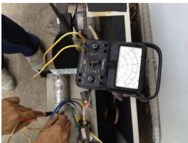
รูป 41 ตรวจสอบการทำงานคาปาซิเตอร์
