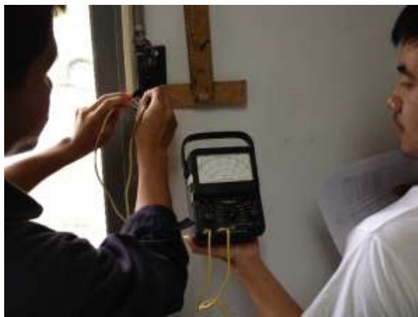
รูป 37 ตรวจสอบเบรกเกอร์ และกระแสไฟเข้าเครื่อง
