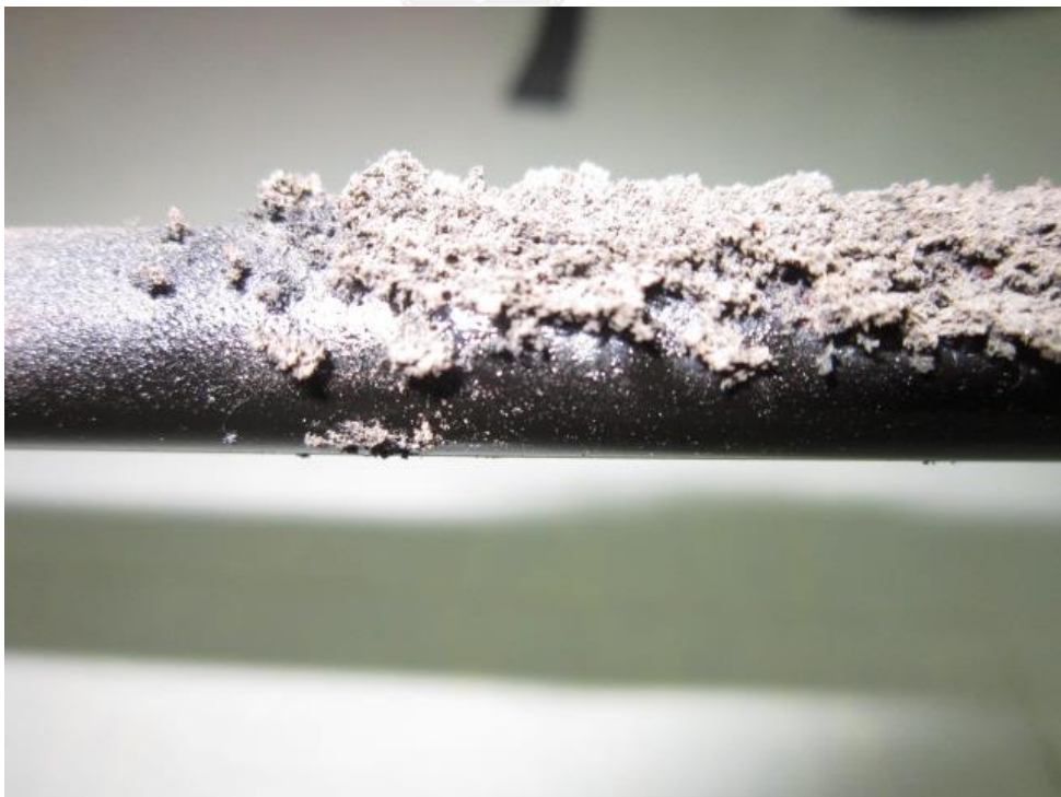
รูปที่ 21 การฝากตัว (Deposit) ของเถ้าลอยที่เกิดจากเชื้อเพลิงเปลือกไม้ยูคาลิปตัสบนท่อตรวจจับความร้อนของหม้อต้มไอน้ำ
