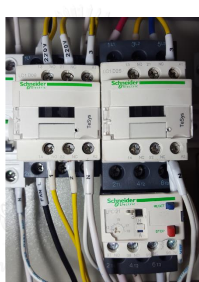
รูปที่ 4.33 Magnetic Contactor และ Thermal Overload Relays
