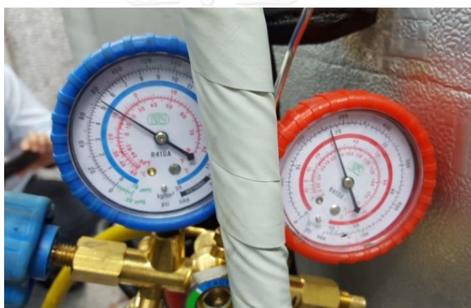
รูปที่ 5.13 แสดงการตรวจวัดแรงดันทางด้านร้อนและด้านเย็น
