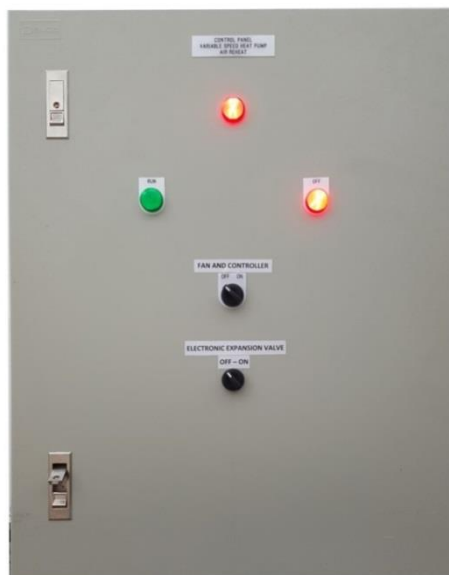
รูปที่ 4.38 แสดงภายนอกตู้ควบคุมเครื่องฮีทปั๊ม
