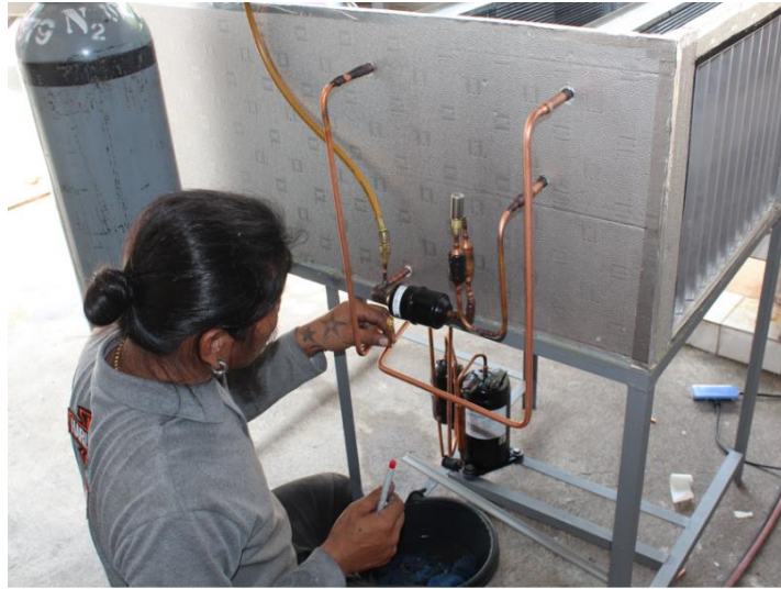
รูปที่ 4.29 แสดงการเดินท่อทองแดงเข้าหาอุปกรณ์ต่างๆ
