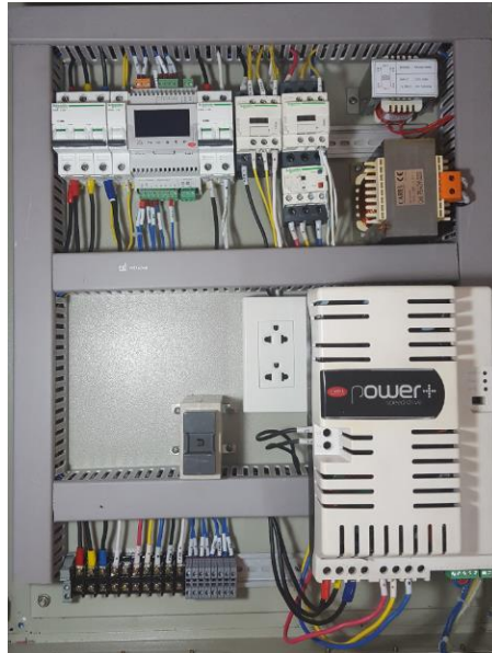
รูปที่ 4.37 แสดงภายในตู้ควบคุมเครื่องฮีทปั๊ม
