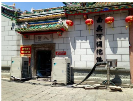
ภาพที่ 129 การติดตั้งเครื่องปรับอากาศชั่วคราวที่ไม่กลมกลืนกับรูปร่างอาคารทำให้คุณค่าทางสุนทรียภาพและสถาปัตยกรรมลดลง
