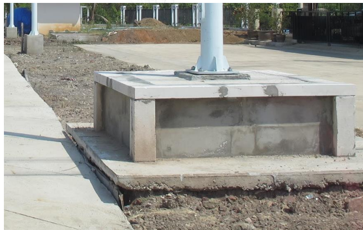
ภาพที่ 4- 5 บริเวณฐานของเสาไฟฟ้าเก็บแบตเตอรี่และตัวควบคุมการจ่ายไฟ
