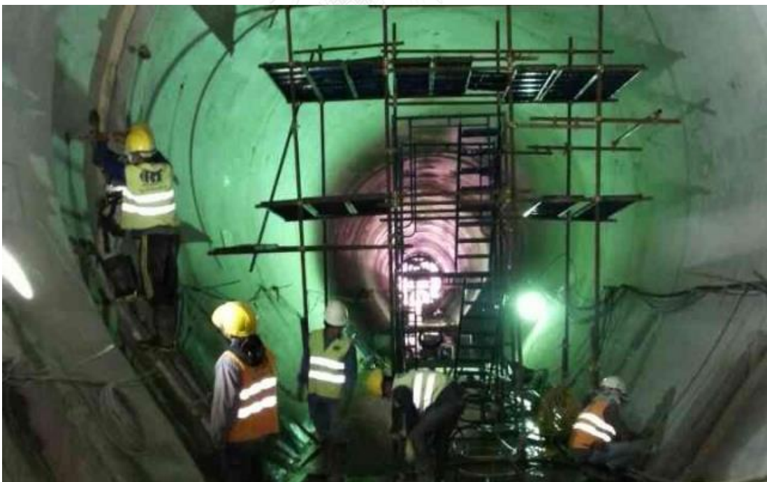
ภาพที่ 4-24 พื้นที่บริเวณโครงการเซเปียน-เซิน้าน้อย ระหว่างดำเนินการก่อสร้าง (ที่มา: ไรท์ทันเน็ลลิง, 2557)
