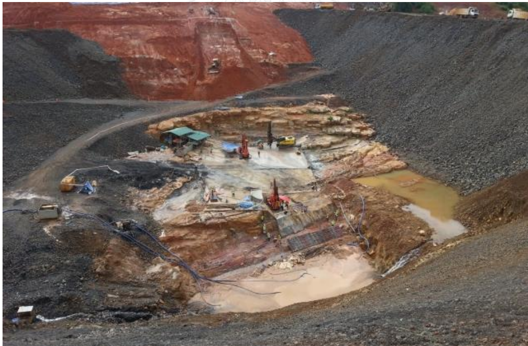
ภาพที่ 4-22 พื้นที่บริเวณโครงการเซเปียน-เซน้ำน้อย ระหว่างดำเนินการก่อสร้าง (ที่มา: ไรท์ทันเน็ลลิง, 2557)
