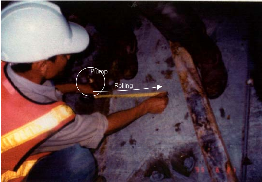
รูปที่ 3.10 ตรวจสอบ Rolling ของผนังอุโมงค์
