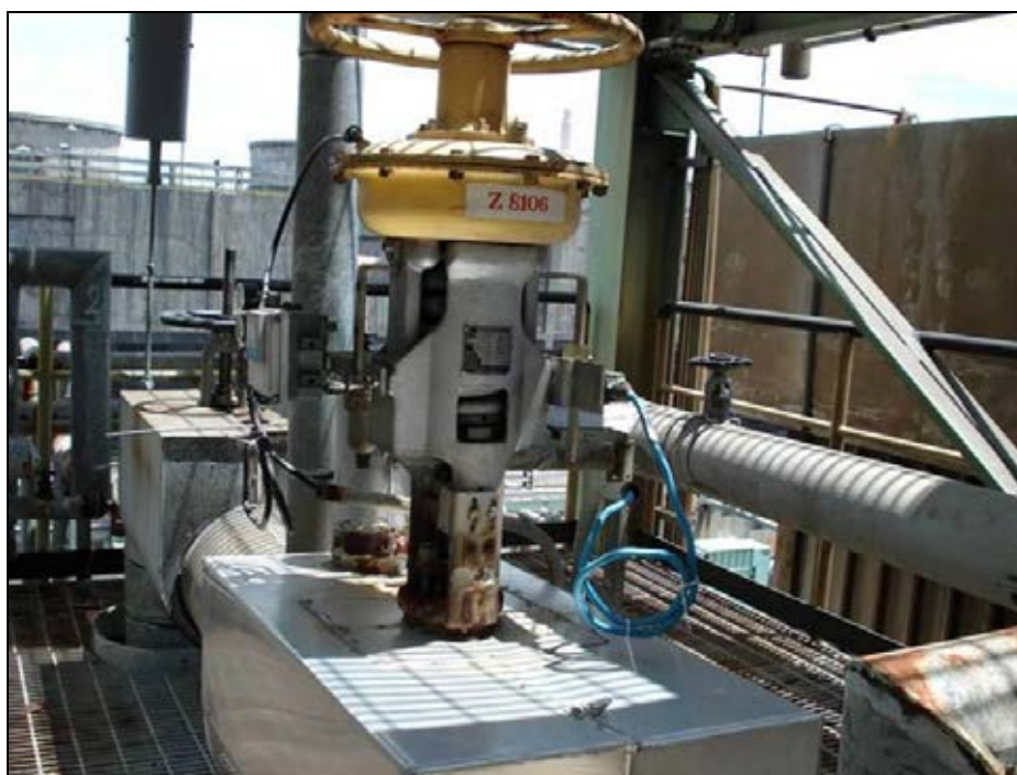
รูปที่ จ.18 สถานีลดแรงดัน Z8106 (LP-LLP Letdown station)
