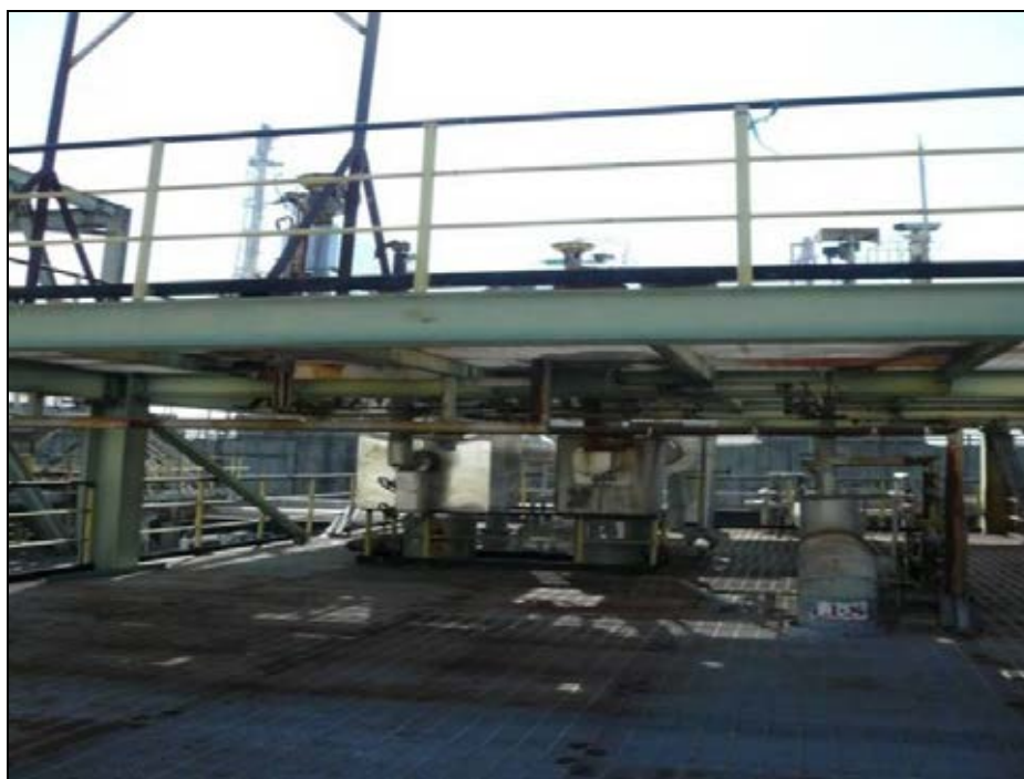
รูปที่ จ.17 สถานีลดแรงดัน (Letdown station)
