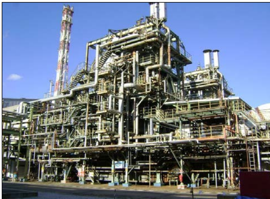
รูปที่ จ.2 หม้อต้มไอน้ำ (Boiler A/B)
