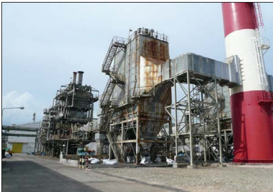
รูปที่ ๑.3 หม้อต้มไอน้ำ (Boiler B)
