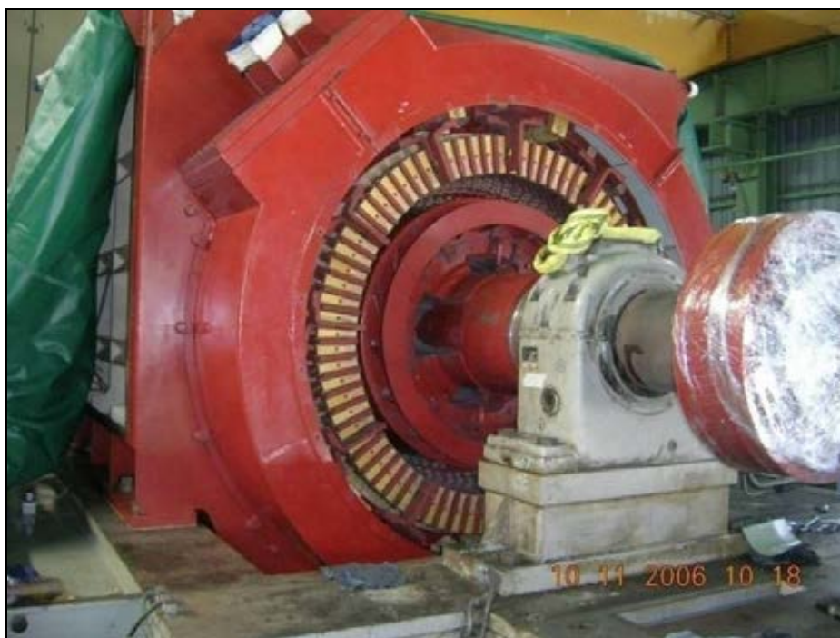
รูปที่ จ.11 ภายใน Turbine House เครื่องกำเนิดไฟฟ้า X8201 (Generator)
