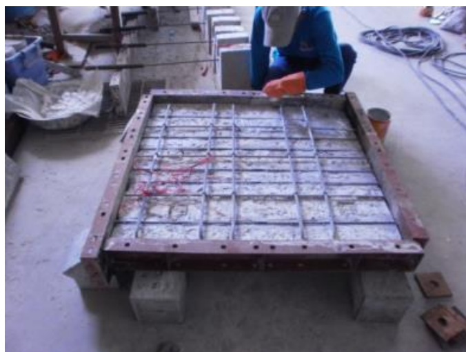
ภาพที่3-17 การตั้งแบบหล่อก่อนเทวัสดุซ่อม
