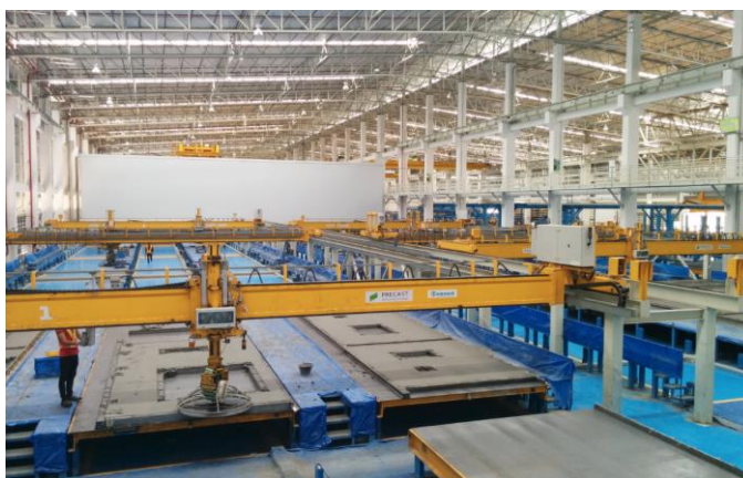
ภาพที่ 104 โรงงานผลิตชิ้นส่วนคอนกรีตสำเร็จรูปที่ 6 บริษัท พุกษา เรียลเอสเตท จำกัด (มหาชน)
