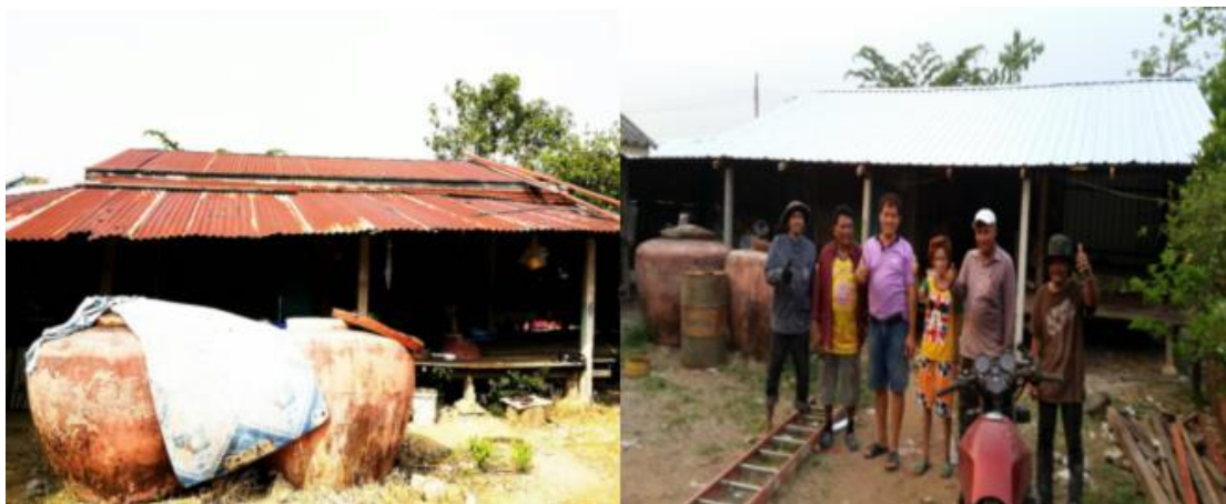
ภาพที่ 5- 2 แสดงกรณีปรับปรุงซ่อมแซมหลังคาที่ผุพัง
