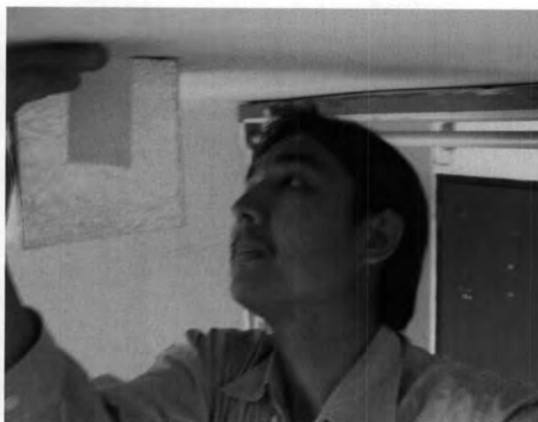
รูปที่ 3.35 แสดงการติดตั้งกล่องที่ห่อหุ้มด้วยฟอยล์ครอบเครื่อง HOBO และหัวตรวจวัด อุณหภูมิบริเวณด้านล่างฝ้าเพดาน ภายในห้องกรณีศึกษา
