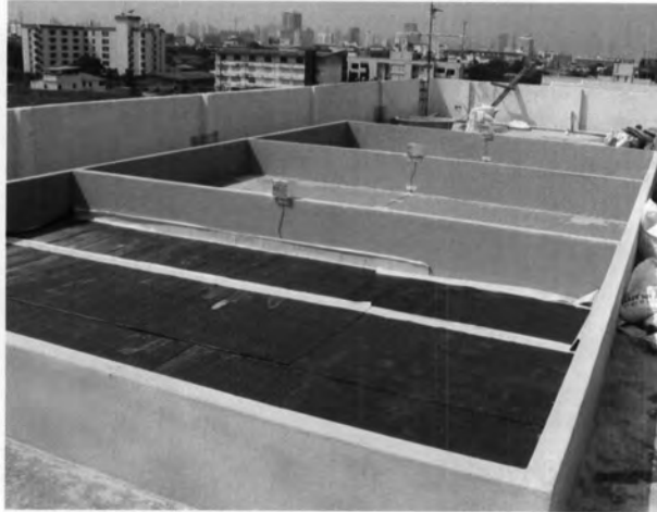
รูปที่ 3.23 แสดงการปูแผ่นกันกระแทกหลังจากที่ได้ทำชั้นน้ำยากันซึมของหลังคา คสล.
