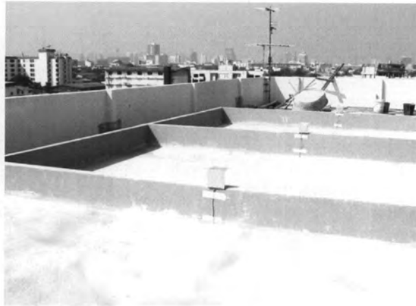
รูปที่ 3.26 แสดงการเทคอนกรีตเพื่อเป็นชั้นคอนกรีตกันทะลุ หนา 6.5 ซม.
