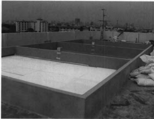
รูปที่ 3.24 แสดงการติดตั้งฉนวนโพลิสไตรีนโฟม หลังจากที่ได้ปูแผ่นกันกระแทก ด้านบนหลังคา คสล. ห้องชั้น 6 ของห้องกรณีศึกษาที่ 4
