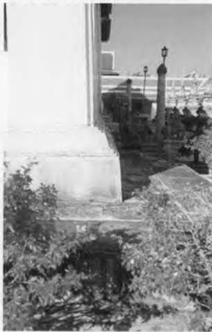
ภาพที่ 5.21 การใช้ฐานเชิงซ้อนใต้ฐานอาคารเพื่อยกอาคารให้สูงขึ้นเป็นพิเศษ วิหารพระพุทธไสยาสน์ วัดราชโอรสาราม
