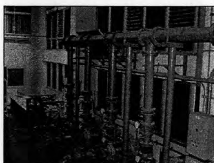
ข) ระบบท่อจากถังเก็บน้ำ
