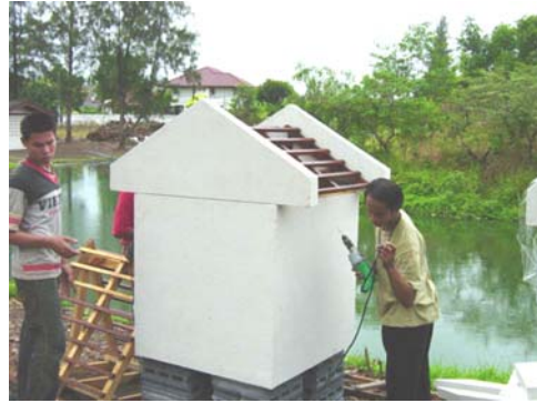
(ง) แสดงการติดตั้งหน้าจั่วที่ใช้วัสดุชนิดเดียวกับตัวผนังหุ่นจำลอง
