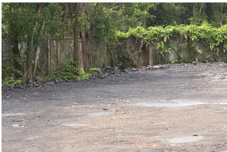
รูปที่ 30 การปรับระดับดินก่อนที่จะก่อสร้างภายในโรงพยาบาลพระปกเกล้า จังหวัดจันทบุรี
