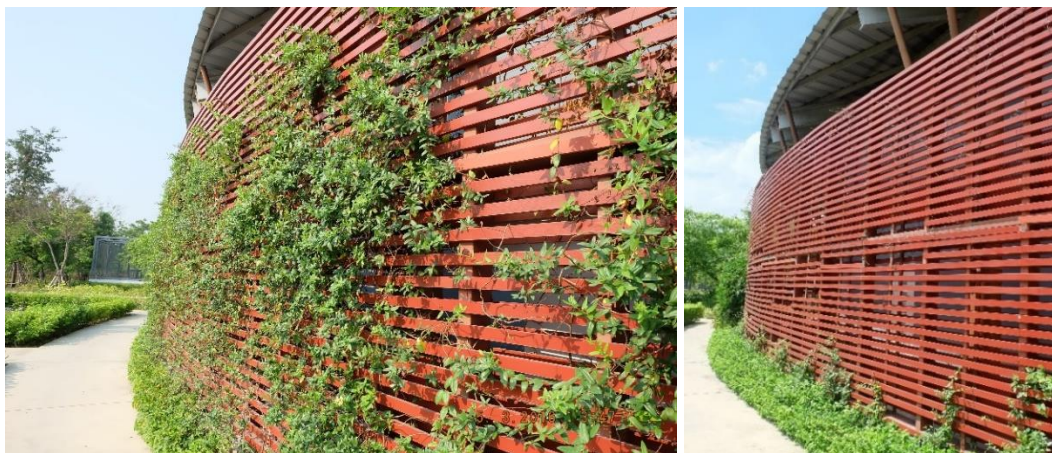
รูปที่ 53 พืชที่เลื้อยเกาะโครงสร้าง สำรวจครั้งที่ 1 (ซ้าย) และพืชที่แห้งตายและถูกรื้อถอน สำรวจครั้งที่ 2 (ขวา)
