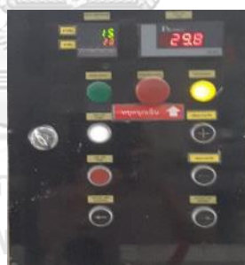
รูปที่ 7.4 หน้าจอแสดงผลควบคุมแรงดันสูญญากาศ
