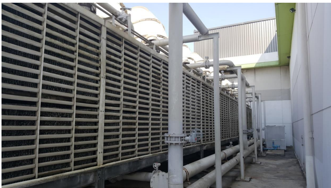
รูป 6 หอผึ่งลมเย็น (Cooling Tower)
