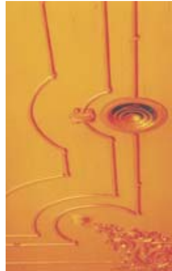
ภาพ 4.16 หน้ากากกลมเย็น ส่วนห้องชั้นสองของ ตำหนักใหญ่ วังบางขุนพรหม ทำเป็นส่วนหนึ่งของลวด ลายบนฝ้าเพดาน ให้ลงตรงตำแหน่งลวดลายพอดี
