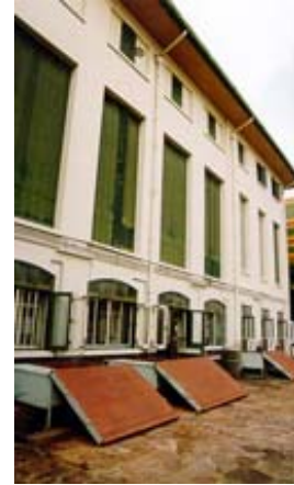
ภาพ 4.11 ตำแหน่งคอนเดนซิ่งยูนิตของพระที่นั่งจักรีมหาปราสาท ตั้งอยู่ด้านหลังของพระที่นั่ง ซึ่งบางจุดเป็นจุดที่ต่อเติมภายหลัง หากมองจากด้านหน้าของพระที่นั่งซึ่งเป็นจุดที่คนทั่วไปผ่าน ก็จะมองไม่เห็น แต่ถ้าหากมองทางด้านหลังก็จะเห็นว่าไม่เข้ากับอาคาร
