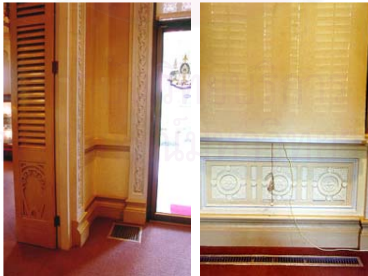
ภาพ 3.59 หน้ากากจ่ายลมเย็นจากพื้น
