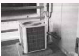
ภาพที่ 2.3 Condensing Unit แบบระบบระบายความร้อนด้วยอากาศ
