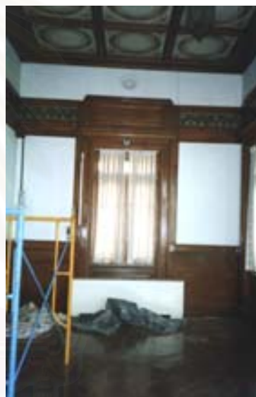
ภาพ 6.30 ห้องพระสมุด เห็นตำแหน่งเครื่องปรับอากาศ ของเดิม อยู่บริเวณใต้หน้าต่างในห้อง
