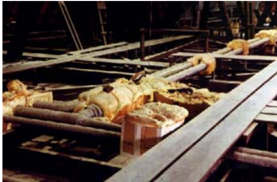
ภาพ 3.68 โฟมพอกบริเวณจุดที่เป็นรอยต่อของท่อน้ำเย็น ซึ่งมักจะมีการกั้นตัวเป็นหยดน้ำเกาะตรงนั้นแล้วหยดลงมาบนเพดาน
