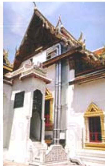
ภาพ 4.13 การเดินท่อส่งความเย็นเข้าสู่พระที่นั่งอมรินทรวินิจฉัย เกาะแนวผนังเข้าสู่อาคารทางใต้หลังคา บริเวณช่องลมตรงใต้หน้าบัน
